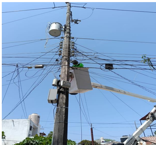
Atención a Circuitos Eléctricos
